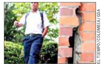
DAÑOS en la ciudad de Cali.
