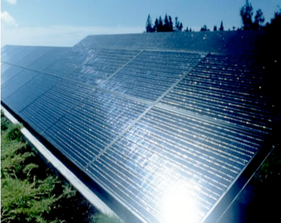
Flat-Plate PV Array
